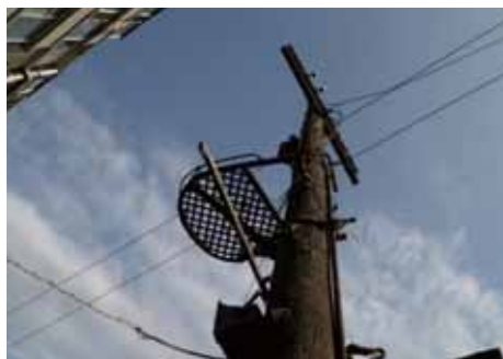
図73. 日本人街木製電柱
